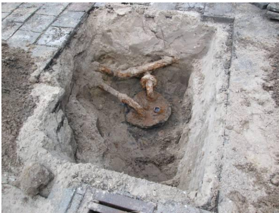
Foto 6: Mangat met leidingwerk en peilpunt 10.000 liter gasolietank. (Peilpunt afgebroken, doorgeroest)
