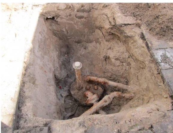
Foto 8: Mangat met leidingwerk en peilpunt 6.000 liter petroleumtank.
